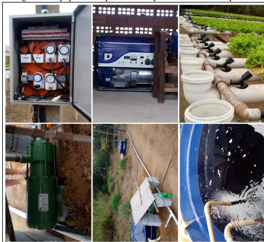
Figura 6 - Equipamentos para a instalação do Sistema Hidropônico.
