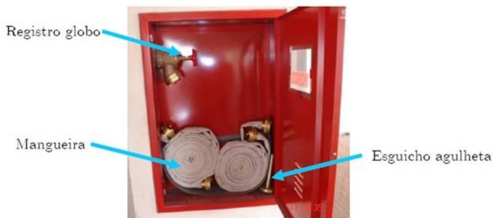
Figura 3: Sistema de Hidrante
