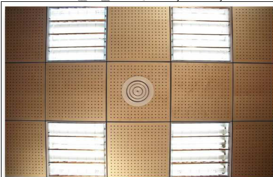
FIGURA 18 – Painel associado ao sistema de climatização e iluminação
